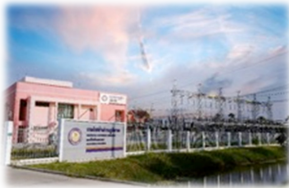
PEA的電力變電站 3 Substations : 300 MW
